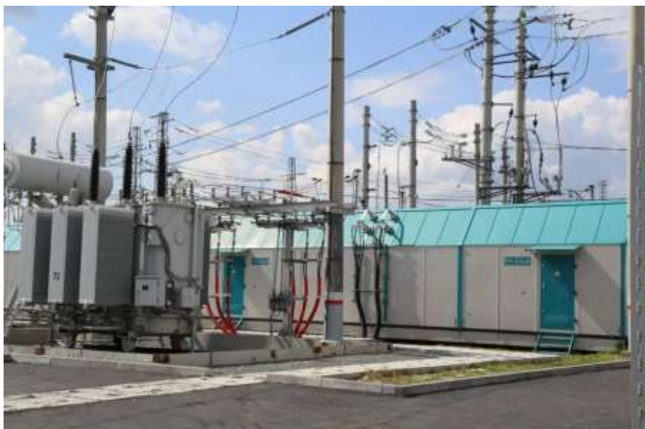
Рисунок 1 – Тяговая подстанция железной дороги
