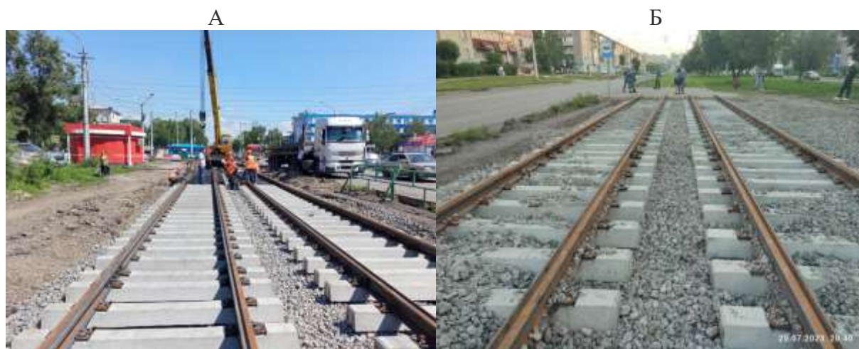
Рисунок 3 (А,Б) – укладка рельсо-шпальной решетки на шпалах ШТ-62 с рельсом т-62 (скрепление шд-65) в г. Новокузнецке
