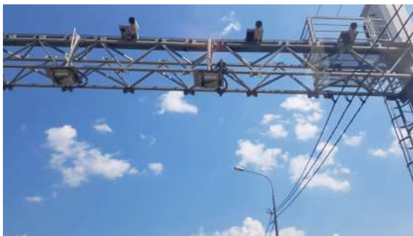
Рисунок 1 – Установка датчиков цифровой фиксации структуры и интенсивности движения автотранспорта на автомагистралях улично-дорожной сети Санкт-Петербурга
