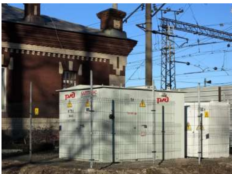
Рисунок 2 – Модульная подстанция железной дороги
